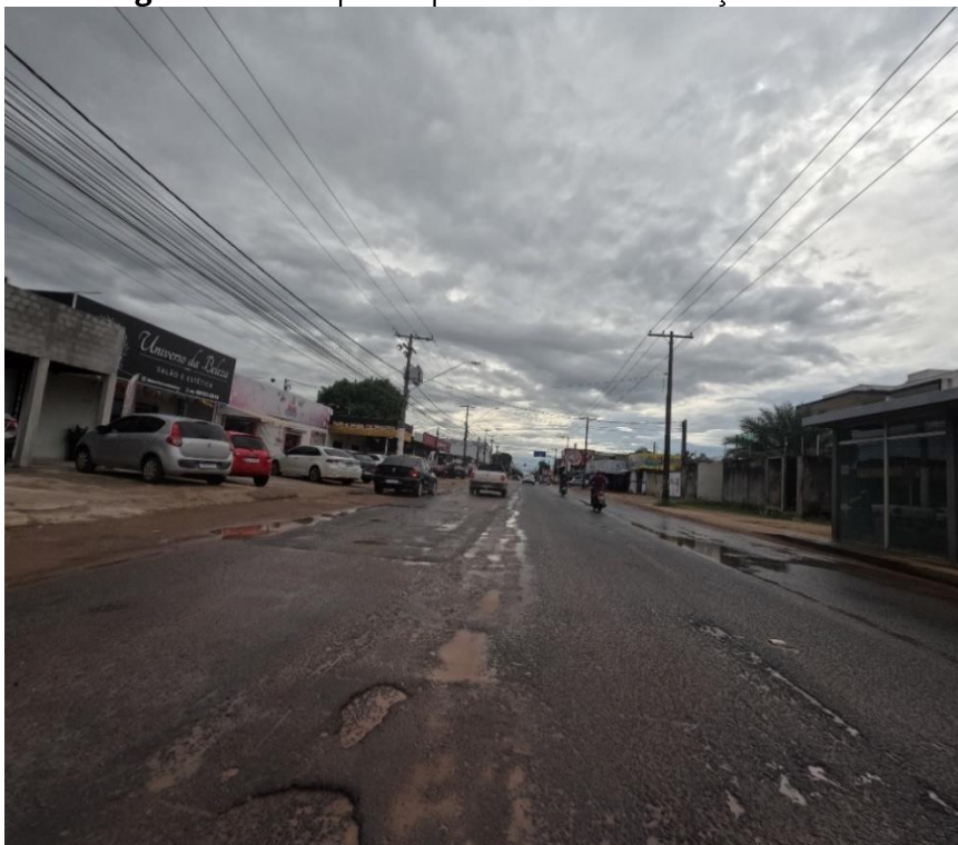
Figura 66: Exemplo de pavimento em condições ruins.
