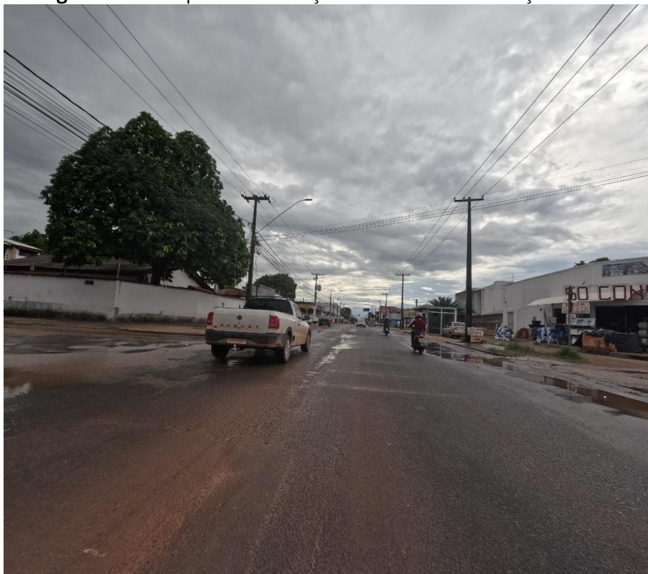
Figura 74: Exemplo de sinalização horizontal em condições ruins.
